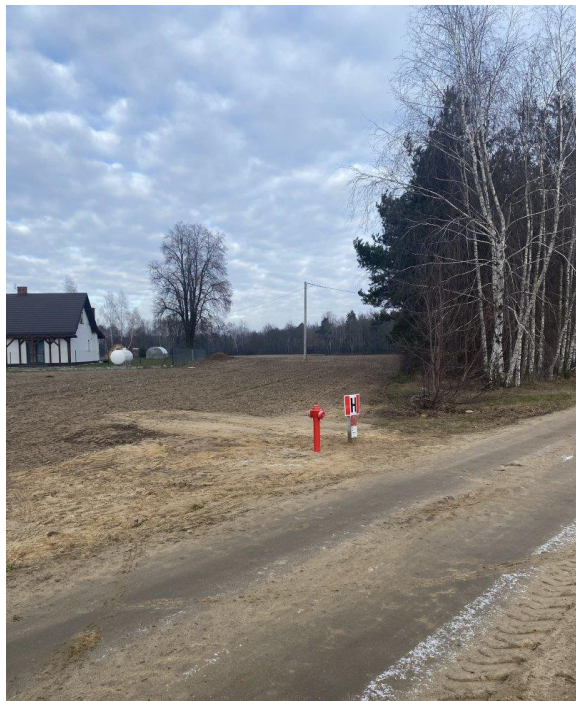
Elementy infrastruktury wodociągowej w miejscowości Mierzeniec
