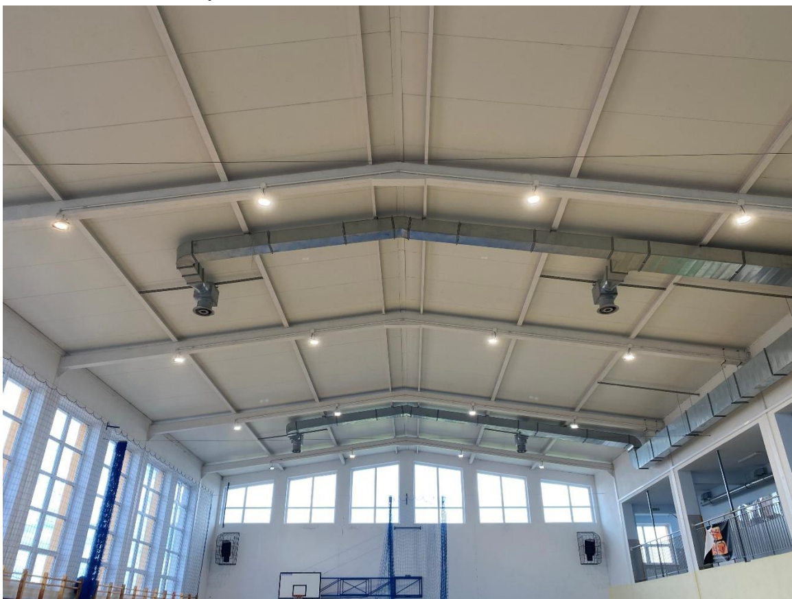
Nowe oświetlenie na hali sportowej w Gzach
